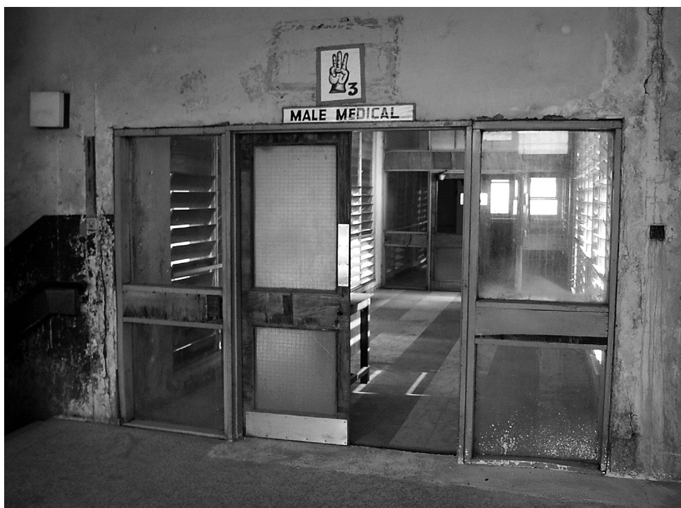
Une salle d'hôpital délabrée à Tamale, au Ghana, mars 2004. (Che Chapman)
